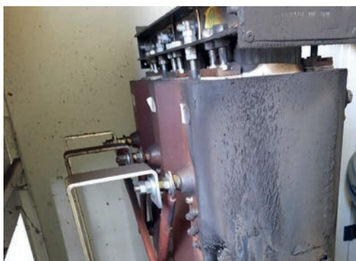
Неисправная катушка трансформатора, которую можно заменить
