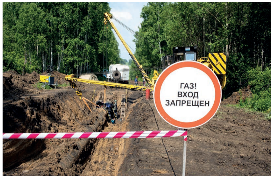
Место проведения работ находилось в лесу, однако газовики, согласно правилам, установили предупреждающие знаки
